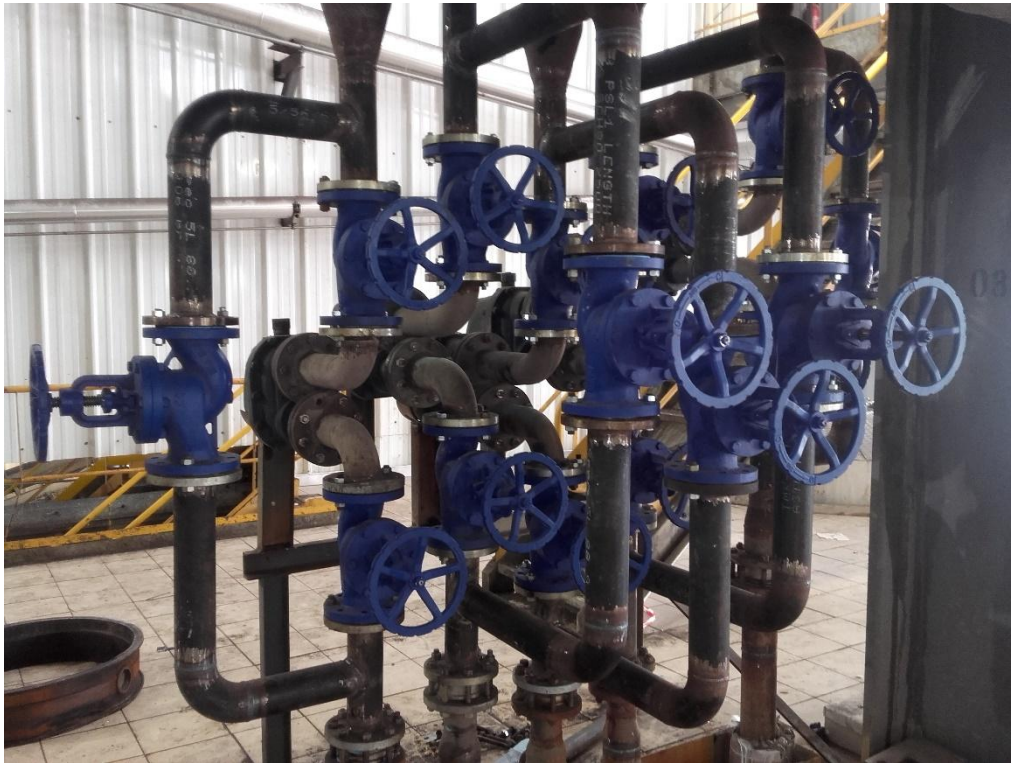
Figure 4 : modification sur les purgeurs des cuites
