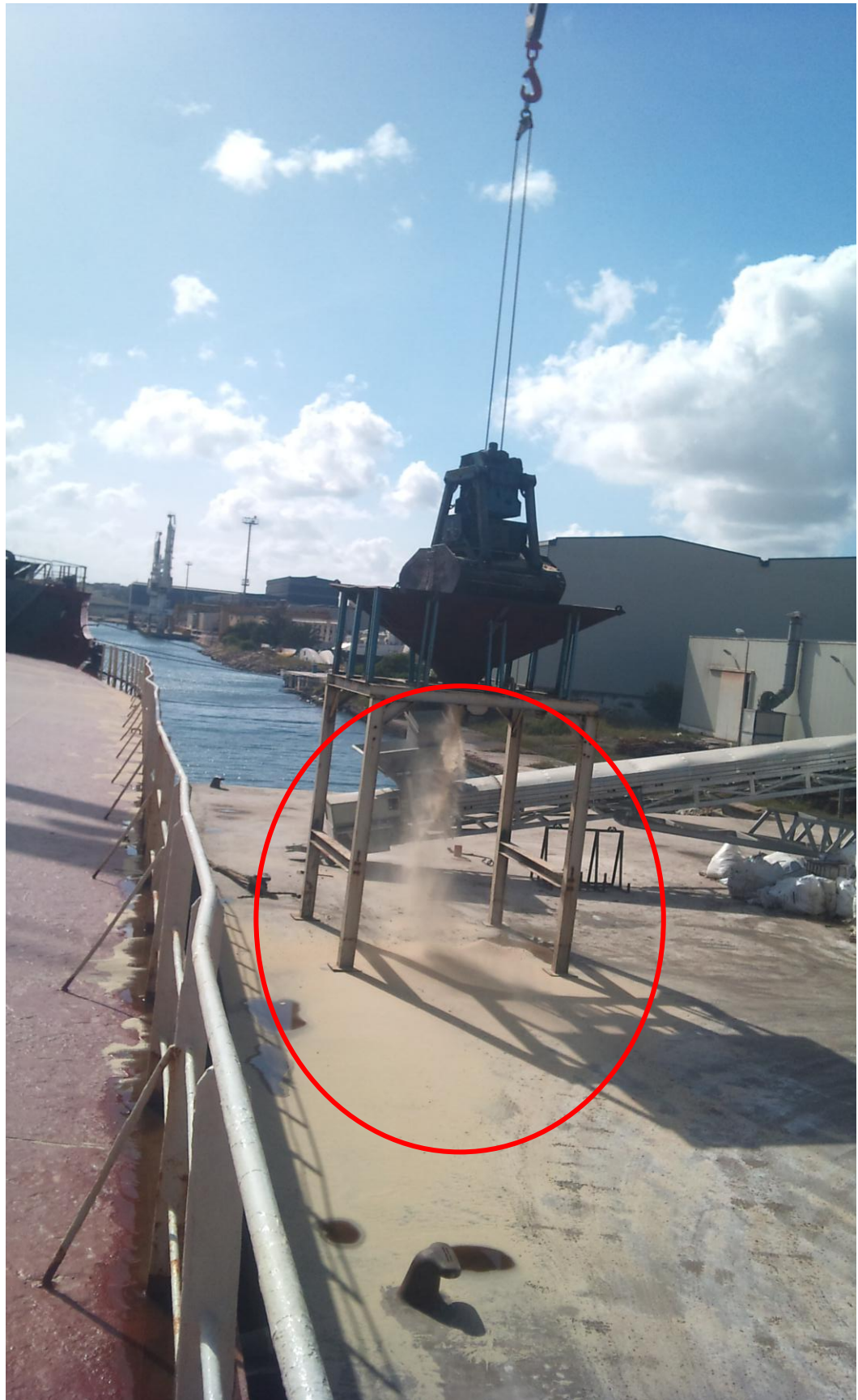
Figure 18 : défaut d'emplacement de la poste N°1
